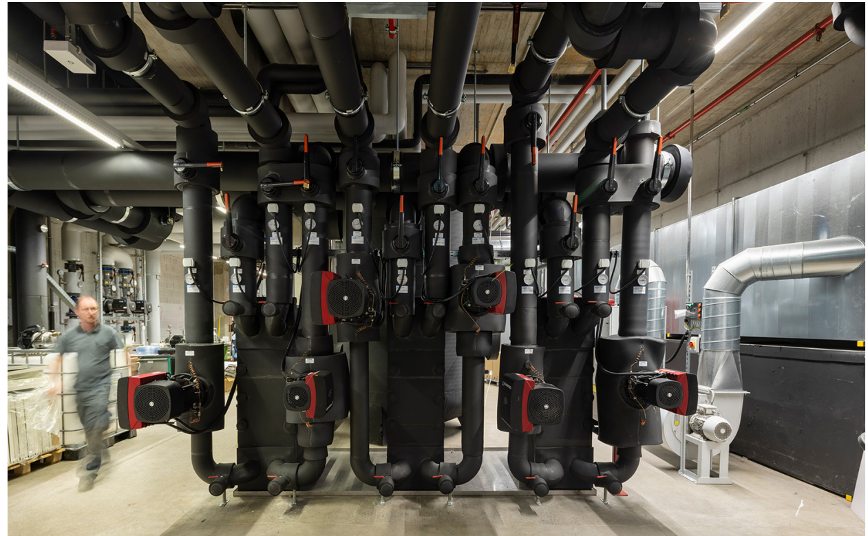
Bild: Neue Kälteversorgungszentrale am Standort Dornbirn Schweizerstraße
